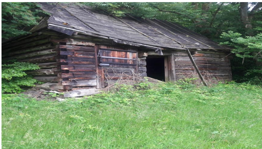
fot. 3. Zniszczona infrastruktura pasterska pod Halą Romanka
